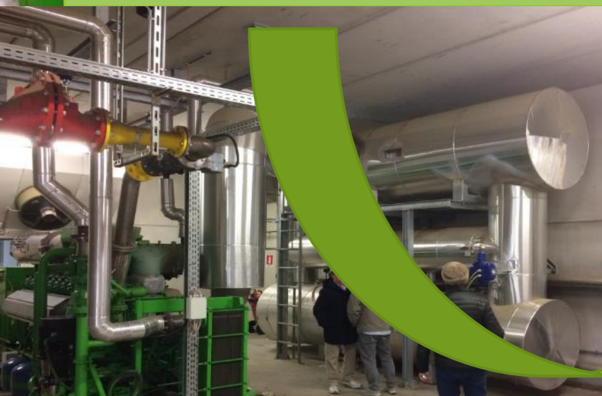
Recuperación de la energía térmica
