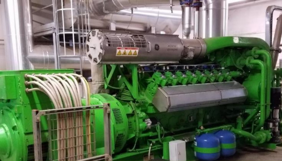
Generador de electricidad y calor
